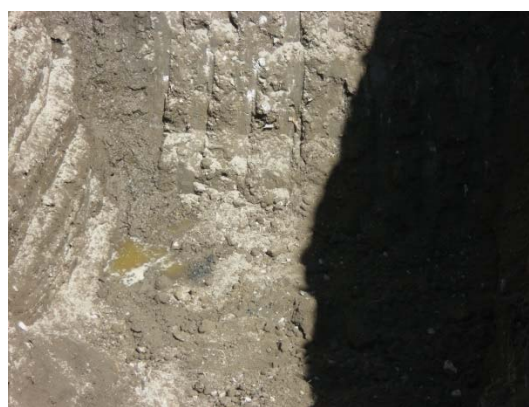
図 1.2-27 浸透水の湧出状況
