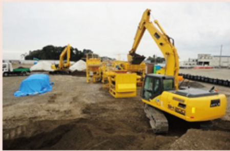
1 混合処理装置全景
