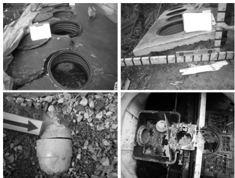
写真：浄化槽の被災状況。左上から時計回りに、スラブの破損、浄化槽の浮上、土砂・がれきの流入、配管のズレ。
