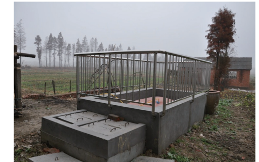
写真1 家庭用廃棄物メタン化施設
