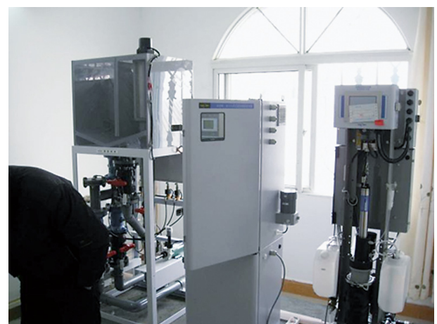
図31 測定システムの設置状況
