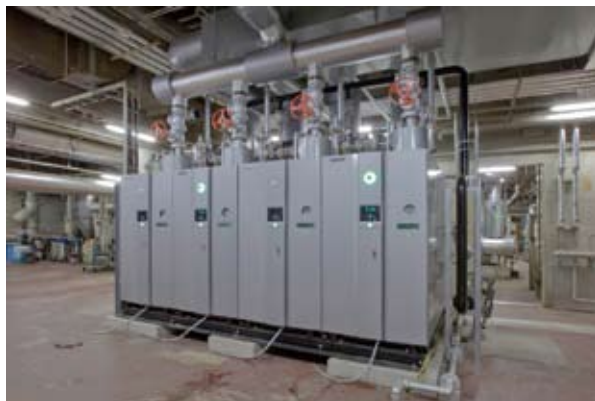
貫流式ボイラー（エネルギーセンター）
