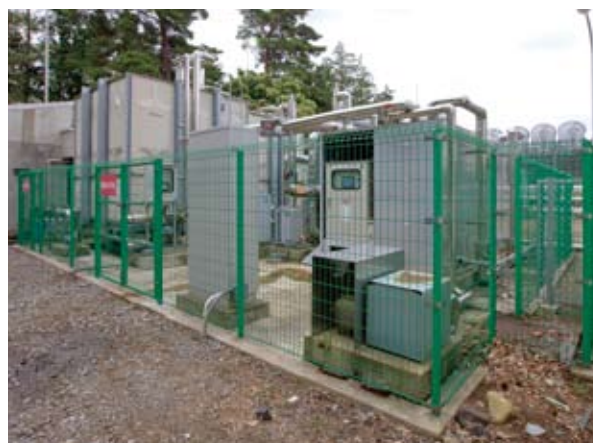
井水ろ過装置
