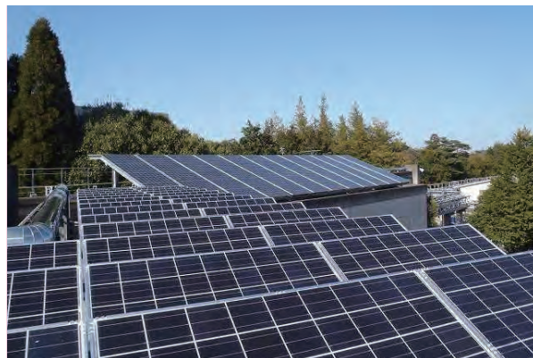
太陽光発電設備（廃棄物処理施設Ⅱ期）
