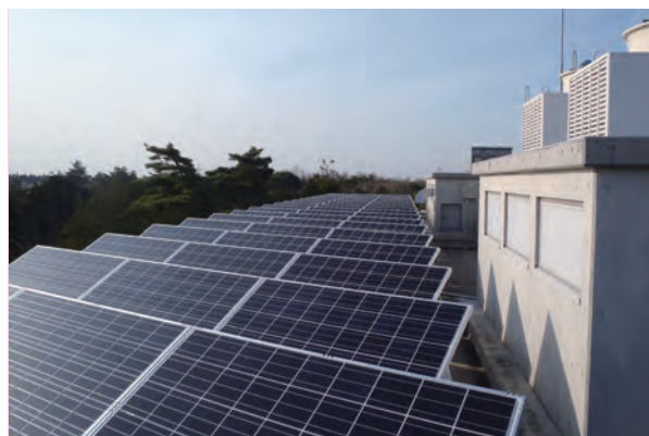
太陽光発電設備（循環・廃棄物研究棟）
