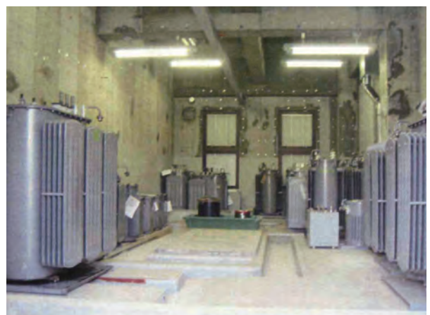
PCB 含有トランス等の保管状況 (水環境保全再生ステーション)
