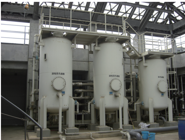
一般実験廃水処理施設
