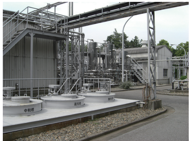
特殊実験廃水処理施設
