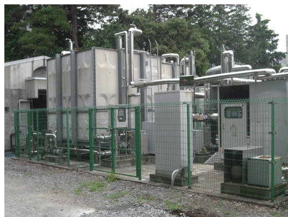
井水ろ過装置
