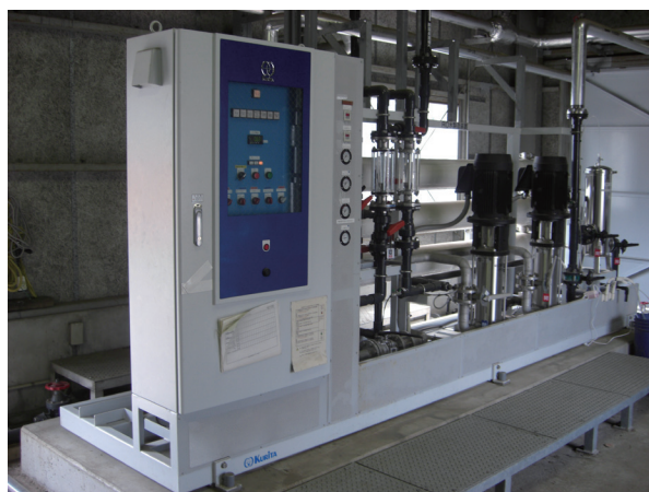
一般実験廃水処理施設再利用水処理施設
