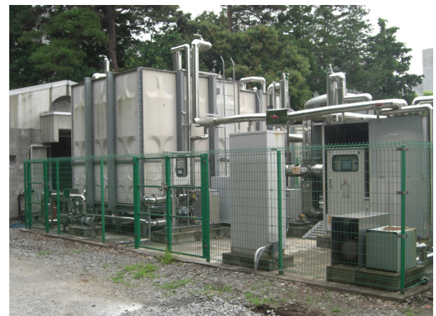
井水ろ過装置
