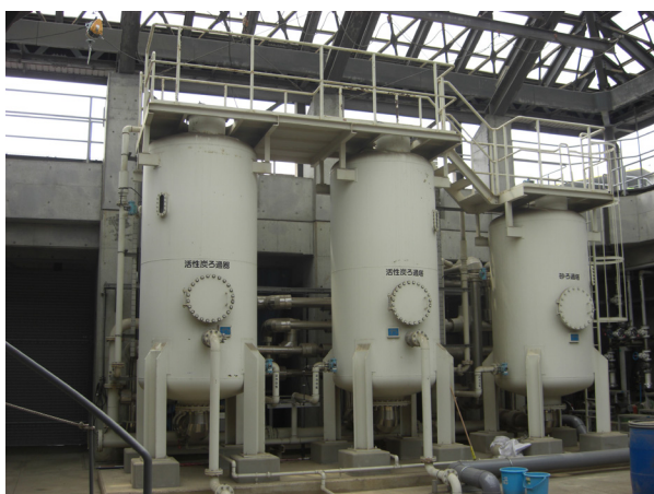
一般実験廃水処理施設
