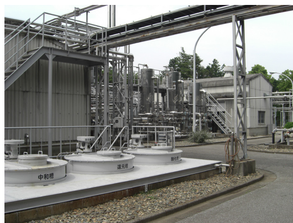
特殊実験廃水処理施設
