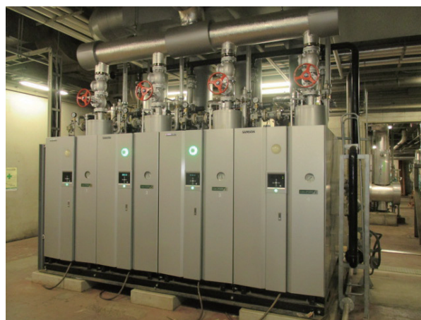
貫流ボイラー
