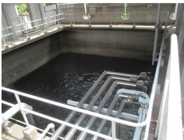
実験廃水処理施設（沈殿槽）
