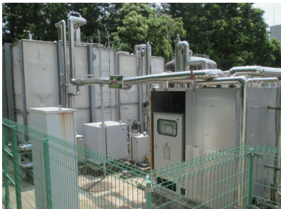
井水ろ過装置
