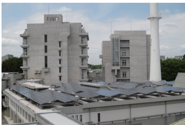
太陽光発電設備 (エネルギーセンター屋上)
