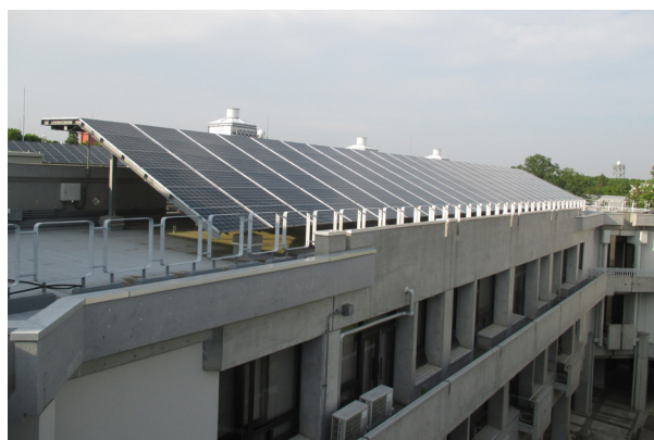
太陽光発電設備 (研究第2棟屋上)
