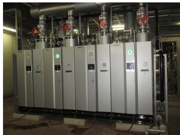
貫流ボイラー
