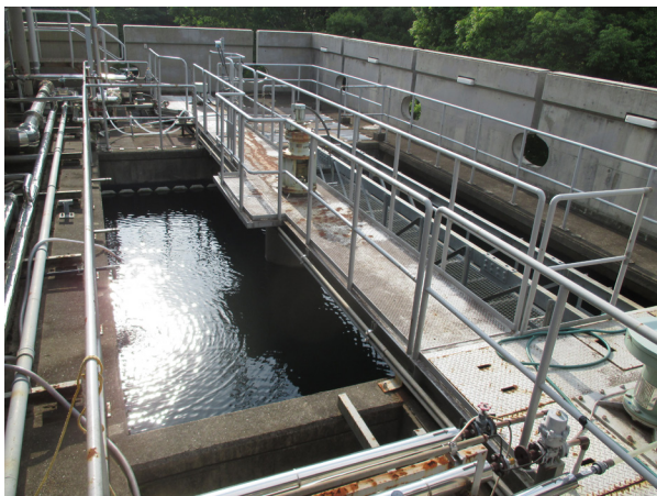
実験系廃水処理施設（沈殿槽）
