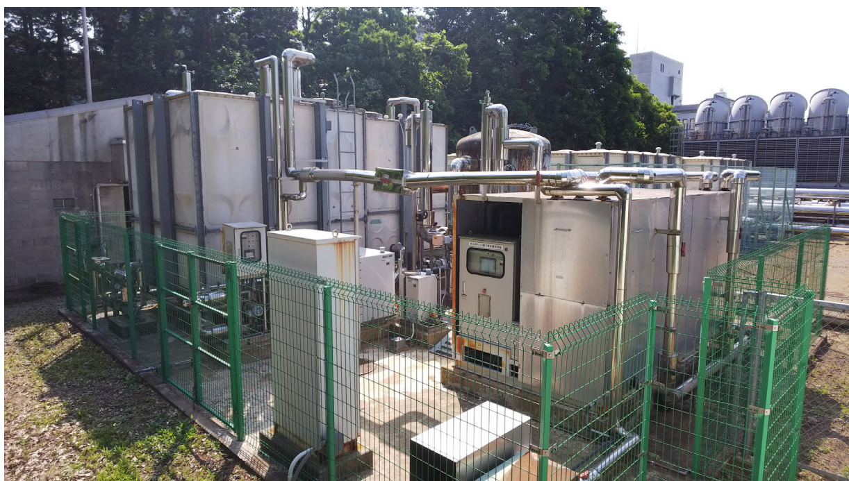
井水ろ過装置
