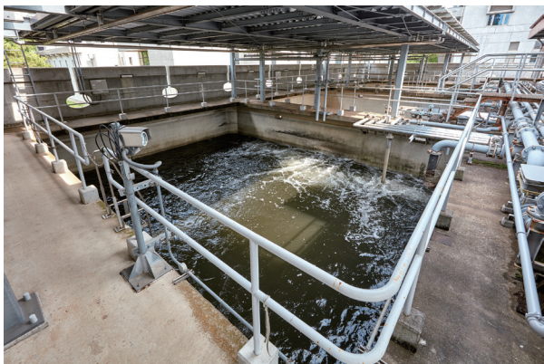
実験系廃水処理施設（貯留槽：500 t × 3 槽）
