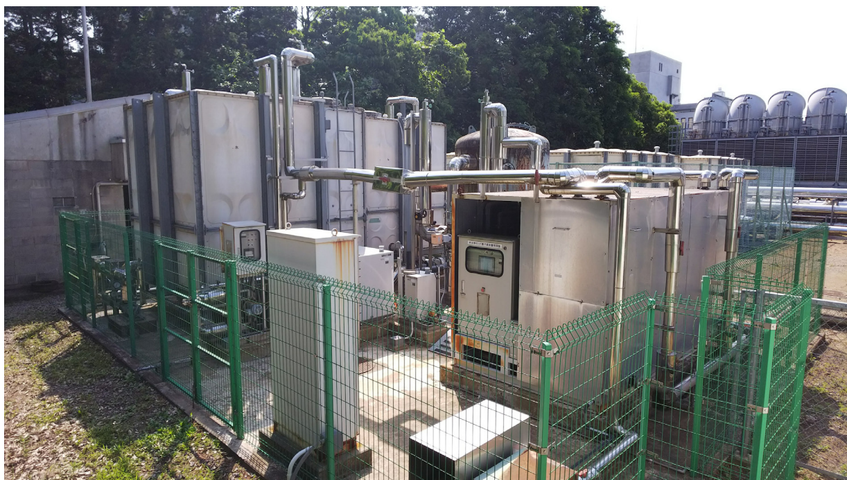
井水ろ過装置
