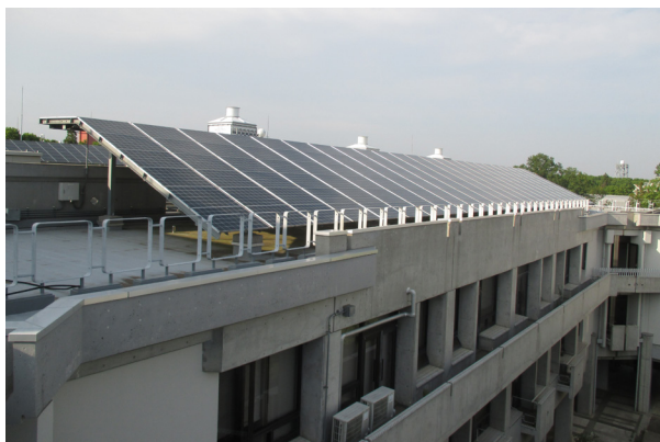
太陽光発電設備 (研究第 2 棟屋上)
