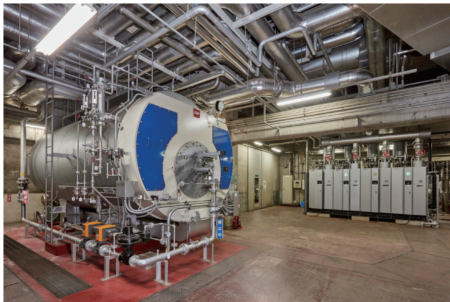
炉筒煙管ボイラー（左側）と貫流ボイラー（右側）
