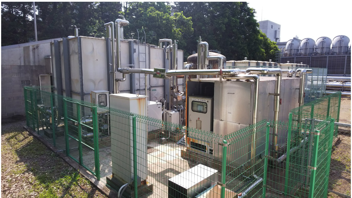
井水ろ過装置
