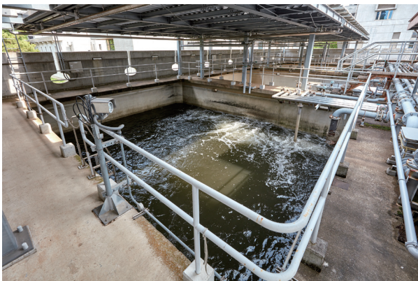
実験廃水処理施設（貯留槽：500 t × 3槽）
