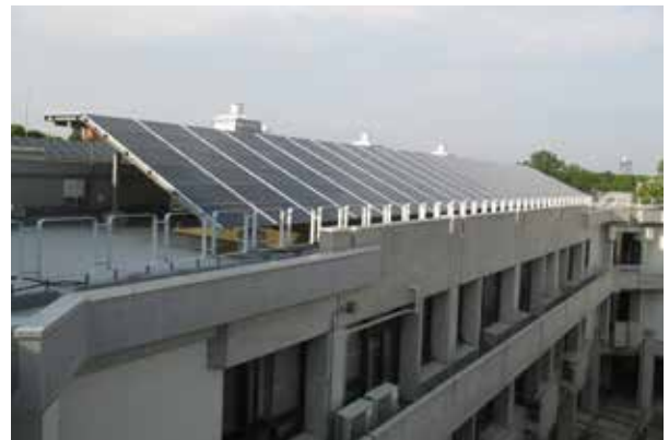
太陽光発電設備（研究本館屋上）
