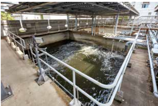
実験廃水処理施設（貯留槽：500 t × 3槽）
