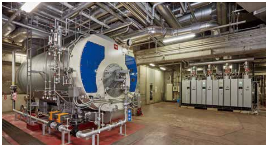
炉筒煙管ボイラー（左側）と貫流ボイラー（右側）
