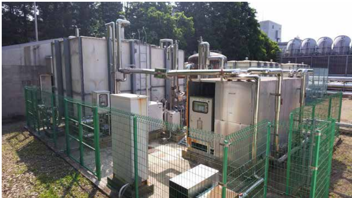
井水ろ過装置
